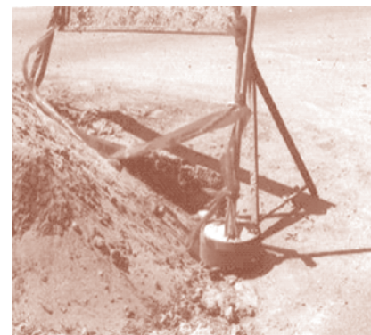
Хаварија канализационог колектора у Козарачкој улици 1999.
