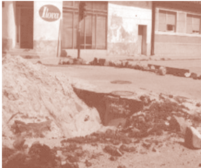
Хаварија канализационог колектора у Карађорђевој улици 1999.
